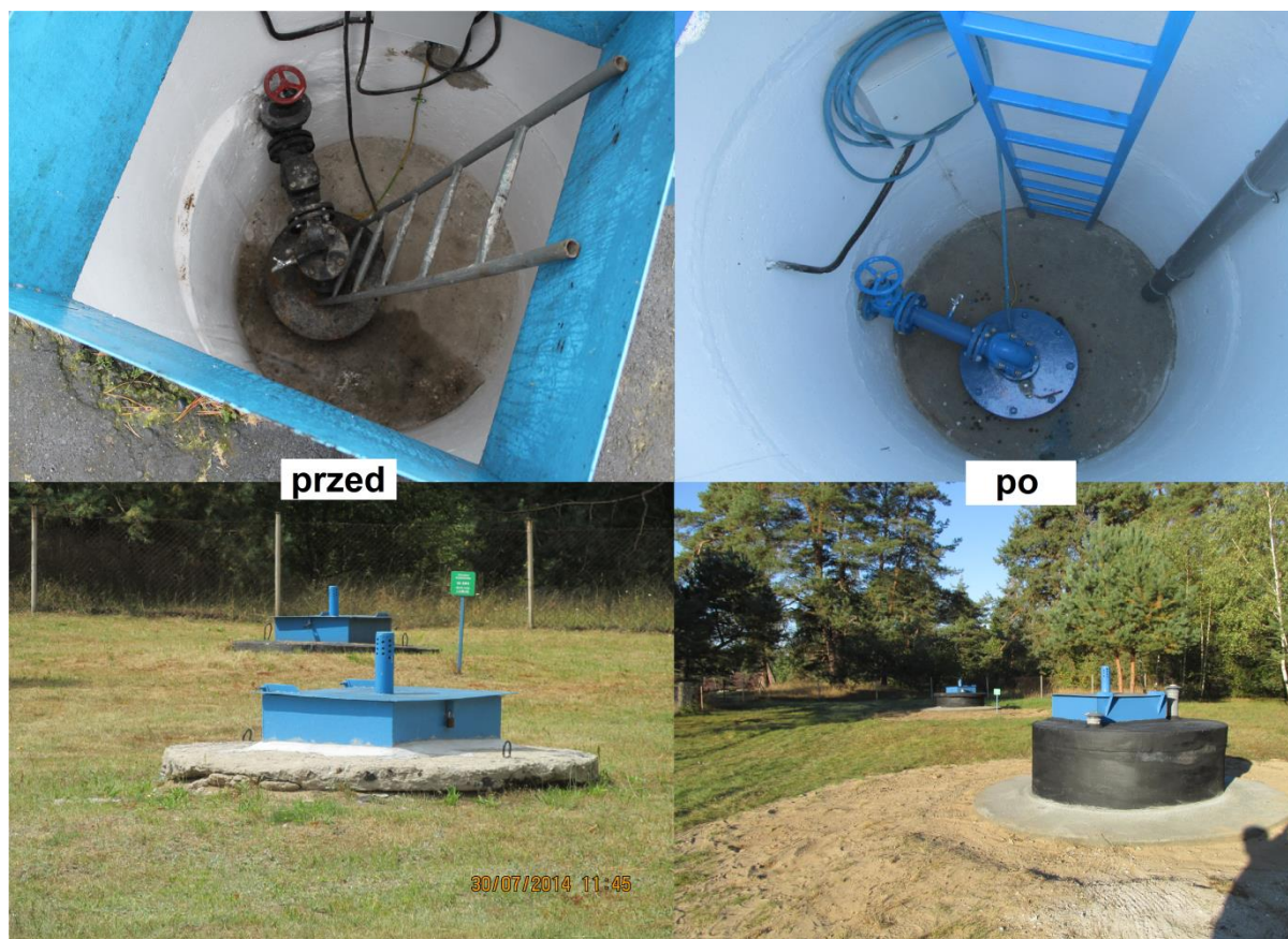
Rysunek 20 Studnia głębinowa w Lubuniu przed i po modernizacji
