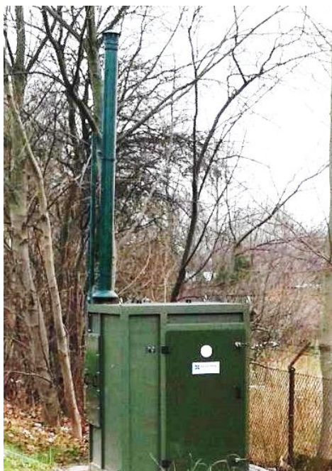
Rysunek 39 – Lokalna stacja dezodoryzacji przy ul. Gdańskiej
