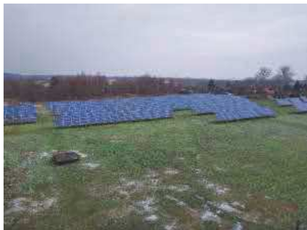
Rysunek 14 Instalacja PV na SUW Westerplatte
