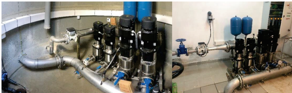
Rysunek 24 Budowa lokalnych stacji do podnoszenia ciśnienia. Po lewej stronie zabudowa w komorze technologicznej wykonanej z kręgów betonowych. Po prawej instalacja wykonana na terenie lokalnej pompowni przy ulicy Legionów Polskich.
